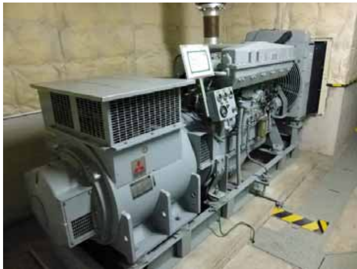
非常用発電機
