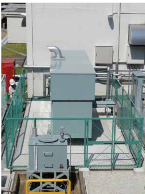
非常用発電機 No.2
